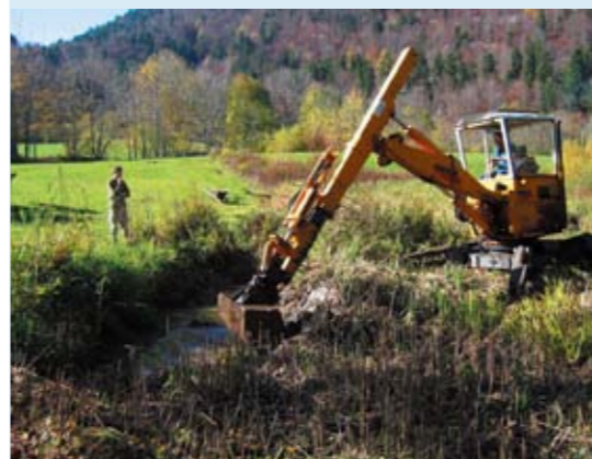
Octobre 2005, l'APSSA organise la revitalisation de l'étang par des travaux de curage importants; M. Ducommun avec sa pelle-rétro.
